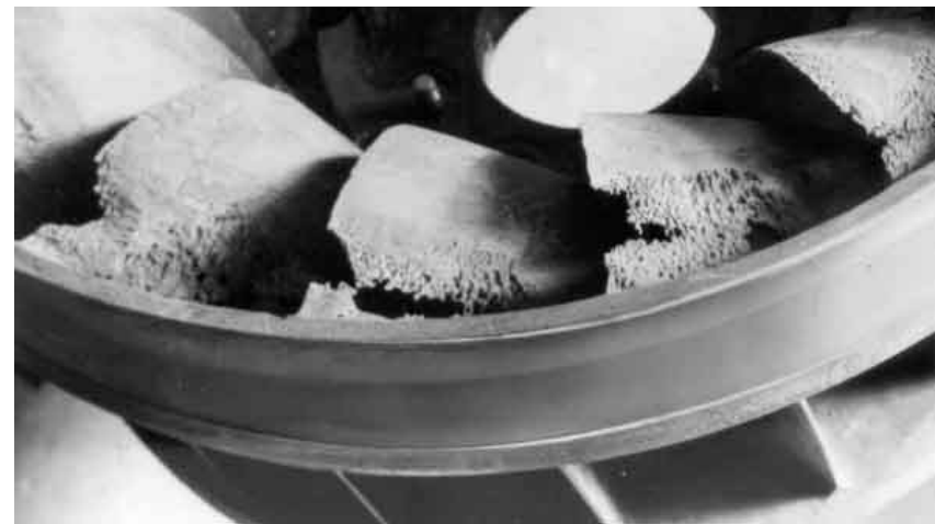
Przykład erozji kawitacyjnej wirnika pompy.
